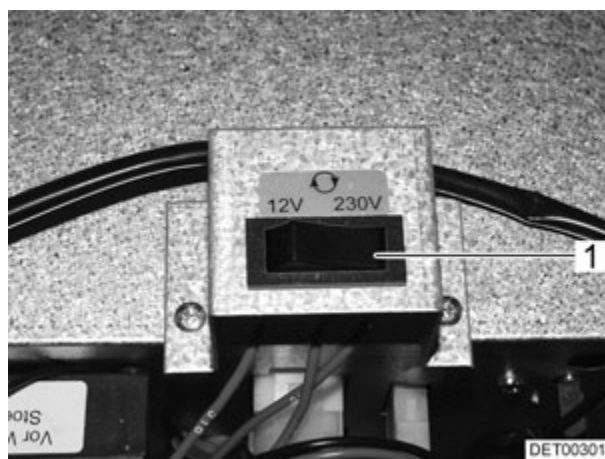
Fig. 102 Commutateur des circulateurs
