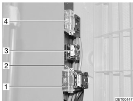
Fig. 145 Fusibles de la batterie de cellule (Fiat)
