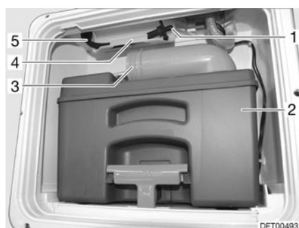
Fig. 241 Tuyau d'écoulement réservoir d'eau toilettes
