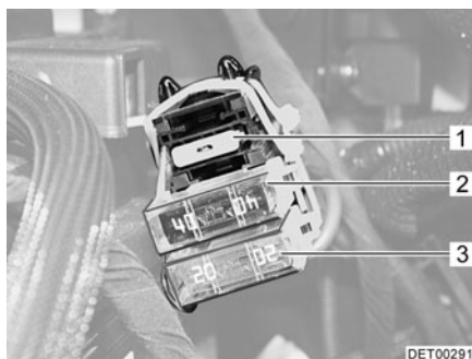
Fig. 144 Fusibles pour la batterie de démarrage (Renault)
