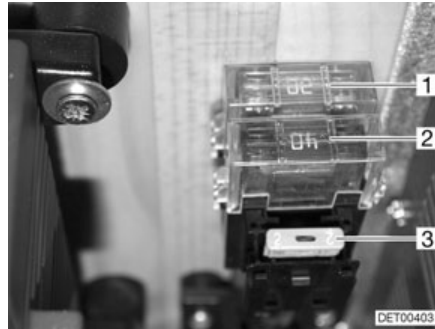
Fig. 170 Fusibles de la batterie de cellule (Renault)
