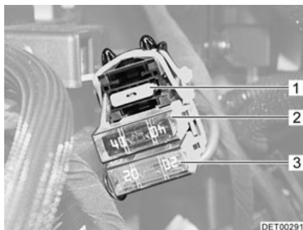
Fig. 167 Fusibles pour la batterie de démarrage (Renault)
